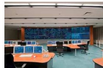
総合制御所システム
