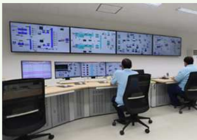
中央監視制御システム
