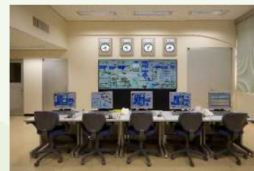
中央監視制御システム
