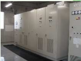
受配電・監視システム
