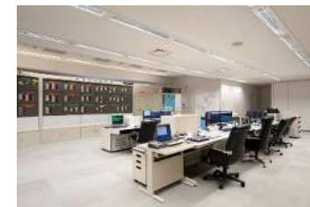
配電自動化システム
