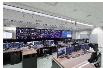
系統給電制御所システム
