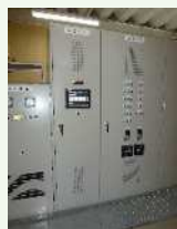
トンネル照明 制御装置
